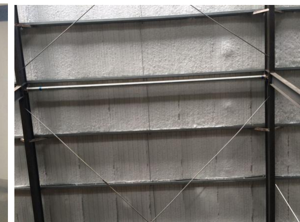
屋面板结霜，高处滴水
